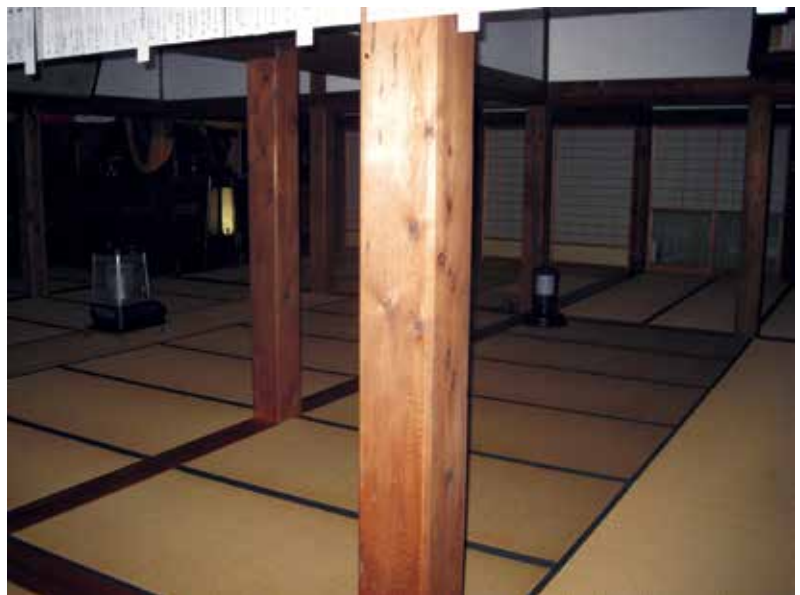
④ 戸出永安寺の柱の傷跡（高岡市戸出）
