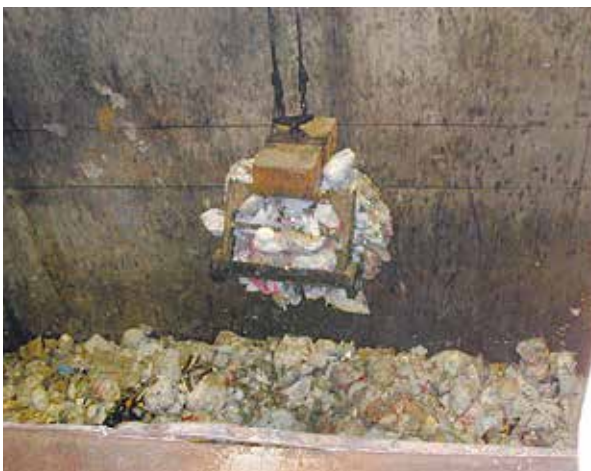
ごみピットの中とごみクレーン
